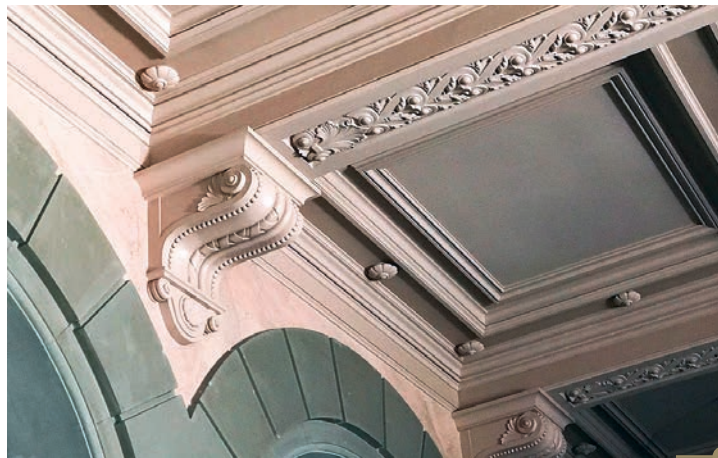
La rénovation du Grand Théâtre figure parmi les investissements importants réalisés par la Ville de Genève dans le domaine de l'immobilier.
